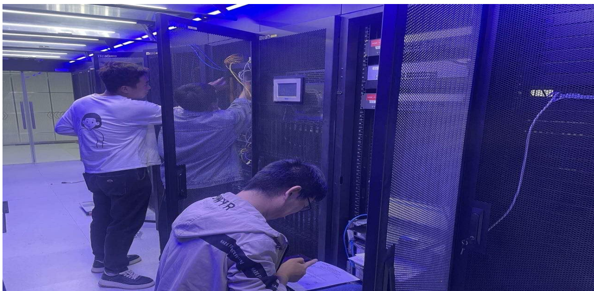
图 37 工作人员在中心机房检修
